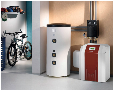
Abb. 8: Erdwärmepumpenanlage mit Wärmepumpe (rechts) und Pufferspeicher (links).
